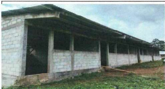
Foto1: Al edificio le hacen falta balcones para las ventanas en la parte de adelante y atrás.
