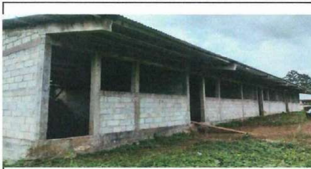
Foto 2: Se observa la falta de puertas de tres aulas y una de dirección.
