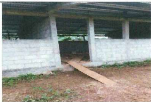
Foto 3: Se observan las aulas no pintadas
