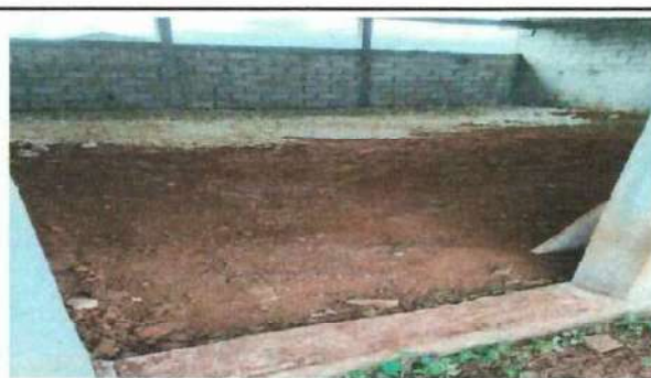
Foto 4: Se tiene la necesidad de colocar piso de cemento en tres aulas.
